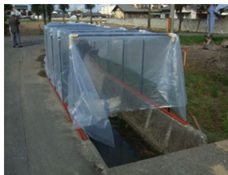
写真 5.1-7 移動が容易な枠付きビニールシートの設置例
