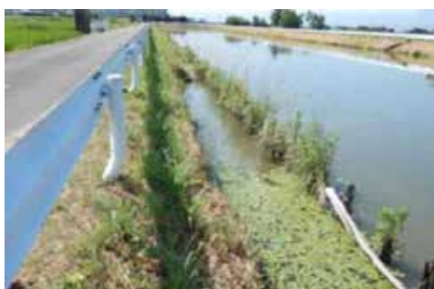
写真-7 クリーク法面崩壊状況
