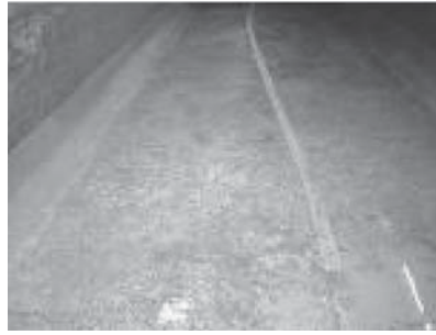
写真-6 底板中性化確認
