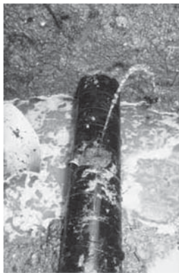
図ー6 マクロセル腐食による漏水
