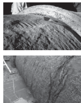
写真-2 PC管の劣化状況
