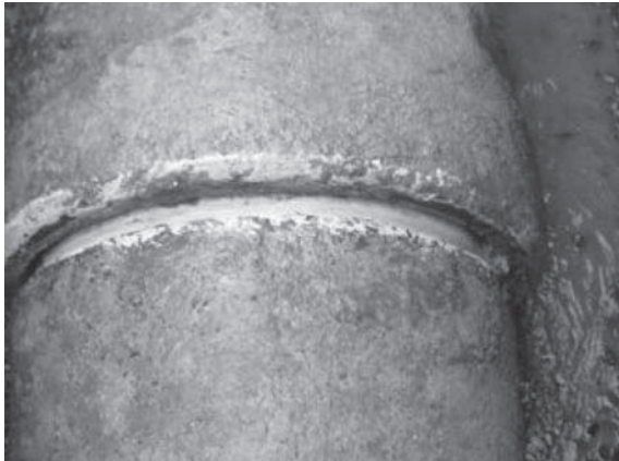
写真-2 PC管継手からの漏水状況
