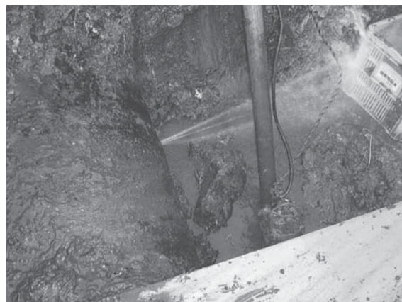
写真-1 C/S マクロセル腐食による漏水状況
