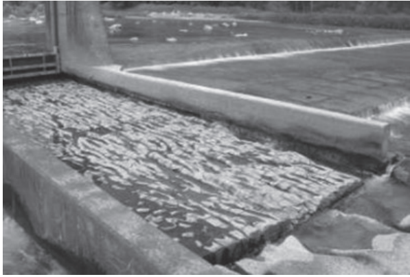
写真-3 土砂吐の摩耗（補修前）
