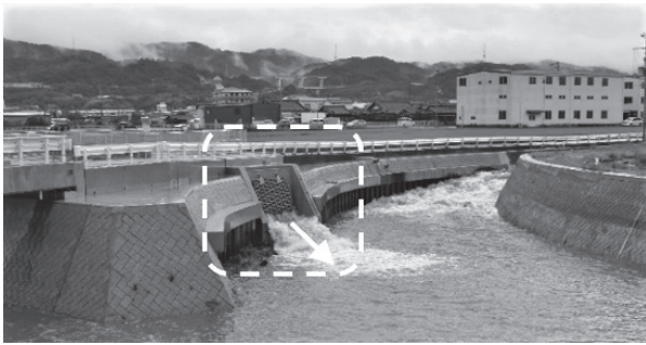
写真 19-2 放流工（七瀬排水路）
