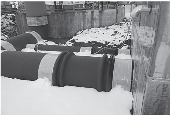
写真-1.2 大変位吸収鋼管 (調圧水槽流入・流出管：口径 1,650mm, 800mm)
