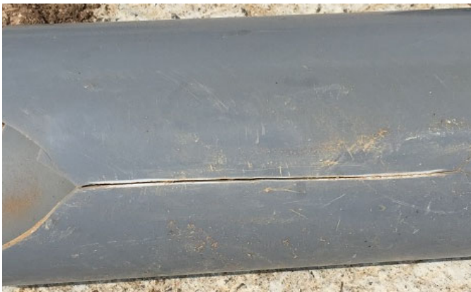
写真3 塩ビ管のき裂の状況
