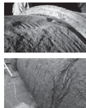
写真-2 PC管の劣化状況
